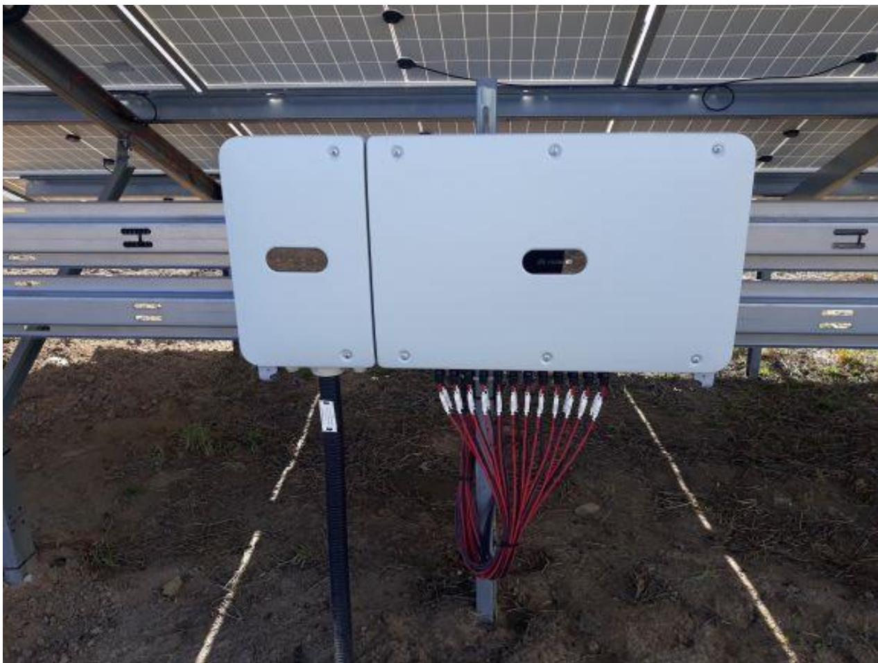
Rycina 9. Przykładowy inwerter farmy fotowoltaicznej.
