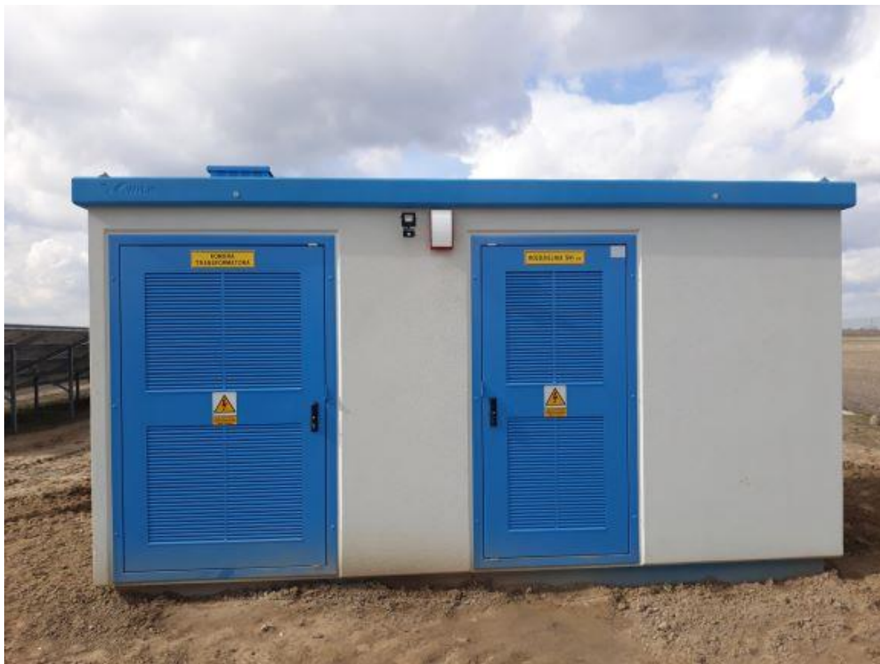
Rycina 10. Przykładowa stacja transformatorowa.
