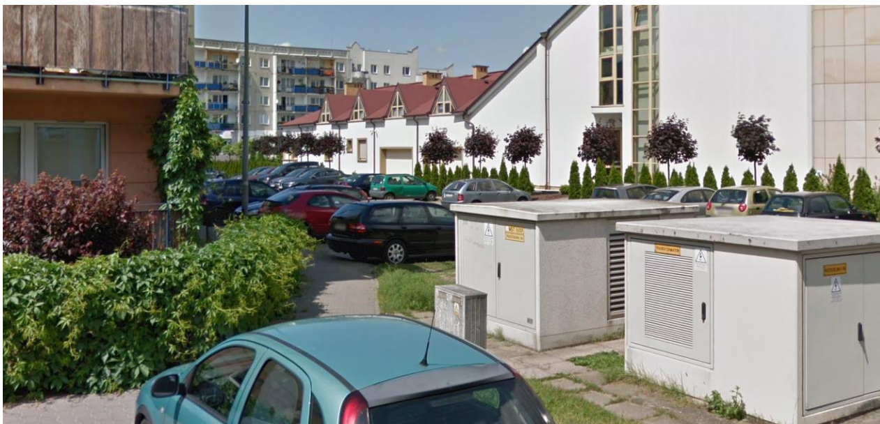
Rycina 11. Standardowa stacja kontenerowa w otoczeniu zabudowy.
