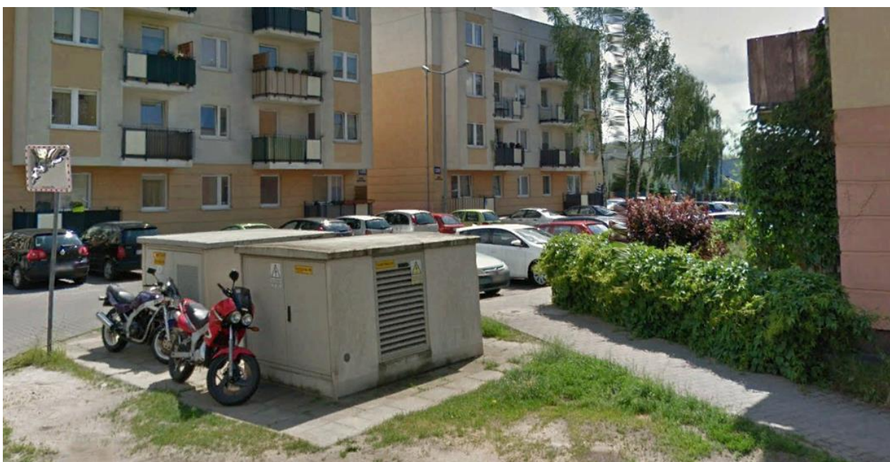
Rycina 12. Stacje transformatorowe w otoczeniu zabudowy mieszkaniowej.
