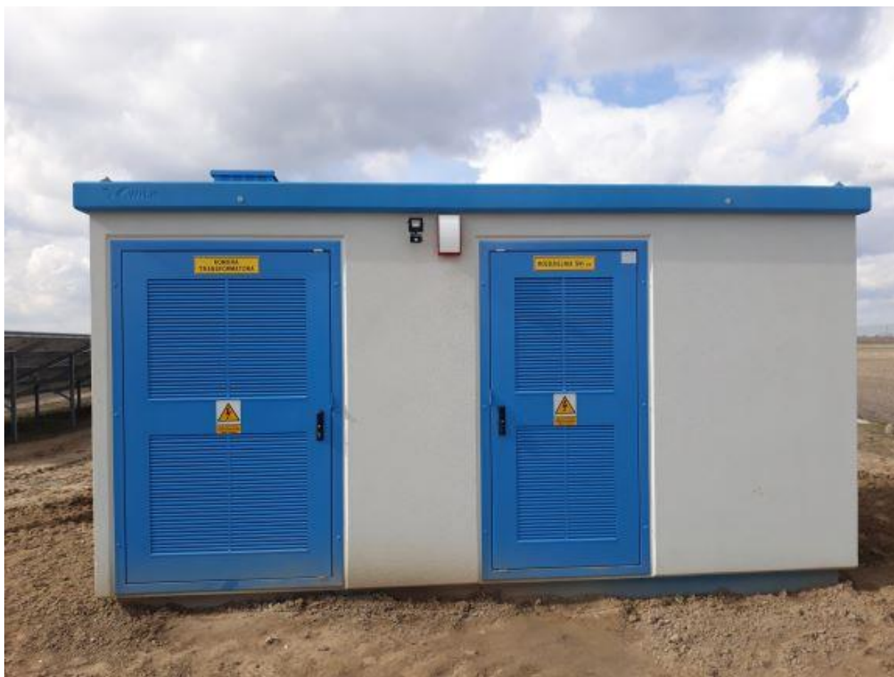
Rycina 10. Przykładowa stacja transformatorowa.
