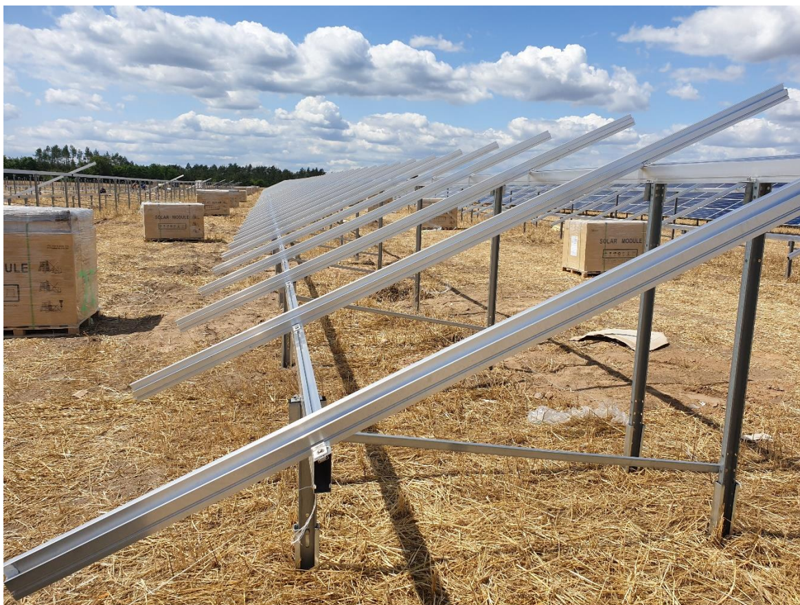
Fot. 4. Konstrukcja przeznaczona do posadowienia paneli fotowoltaicznych.
