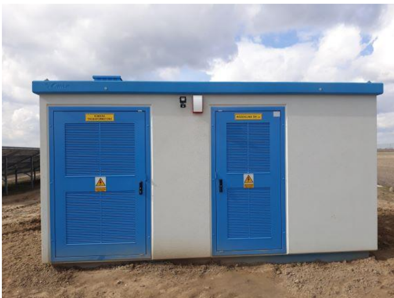
Rycina 10. Przykładowa stacja transformatorowa.
