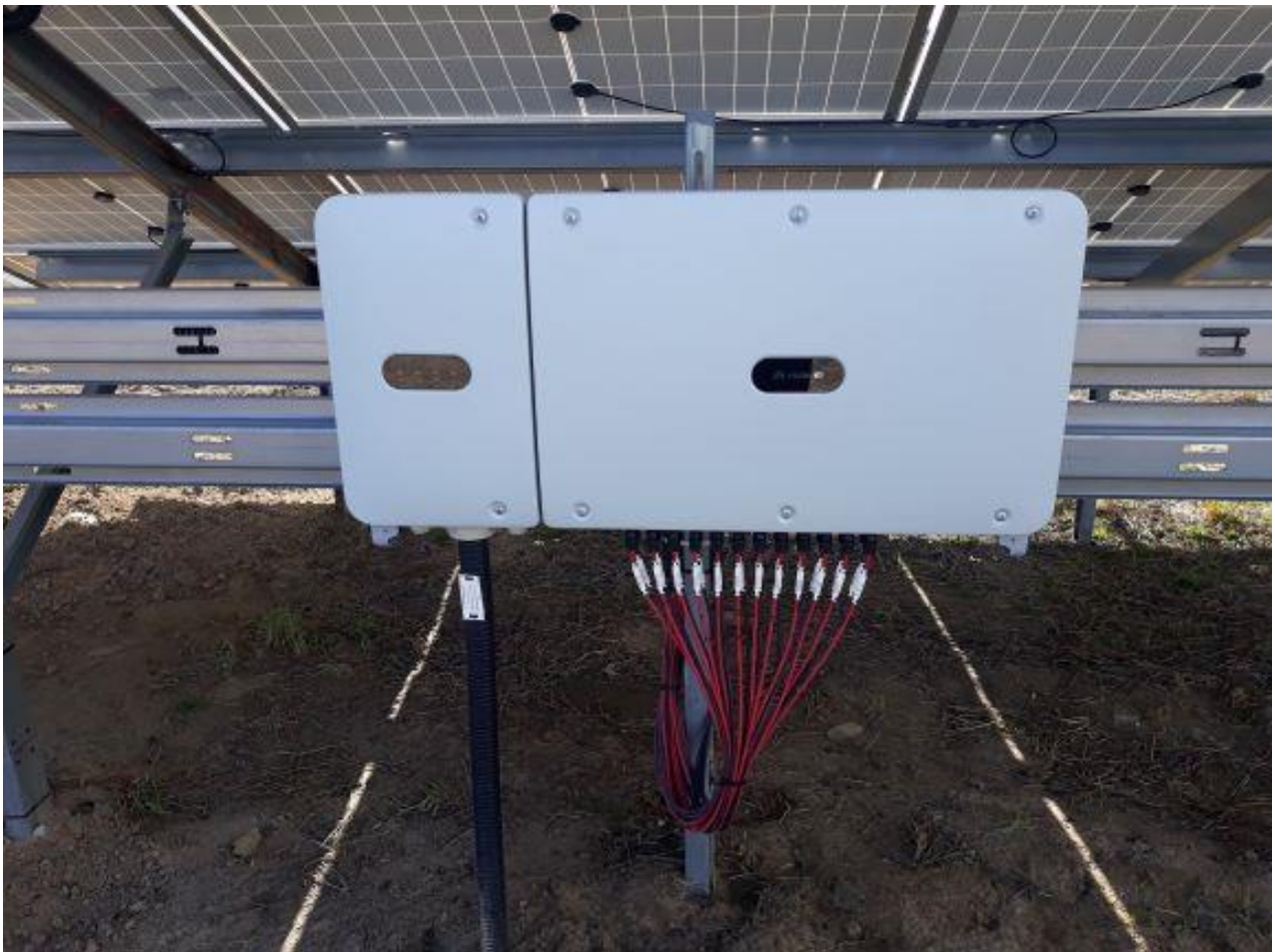
Rycina 9. Przykładowy inwerter farmy fotowoltaicznej.
