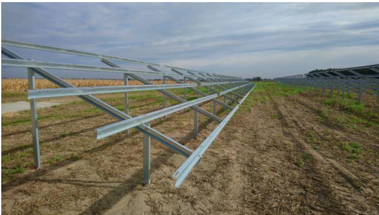
Rycina 5. Konstrukcja przeznaczona do posadowienia paneli fotowoltaicznych.
