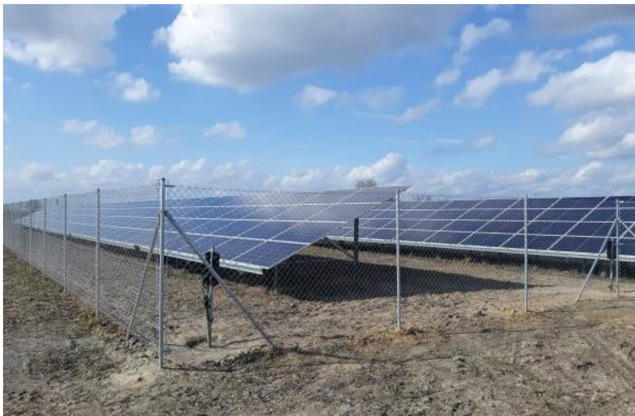
Rycina 13. Przykładowe ogrodzenie farmy fotowoltaicznej.
