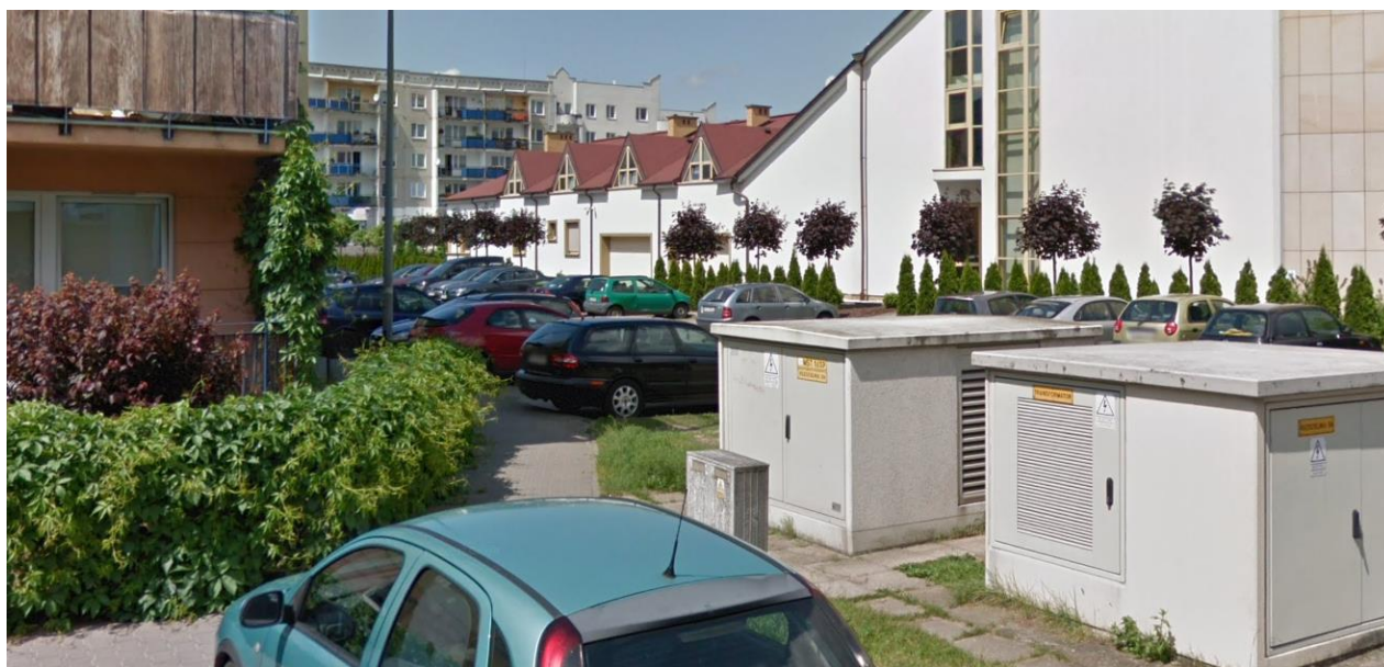
Rycina 11. Standardowa stacja kontenerowa w otoczeniu zabudowy.
