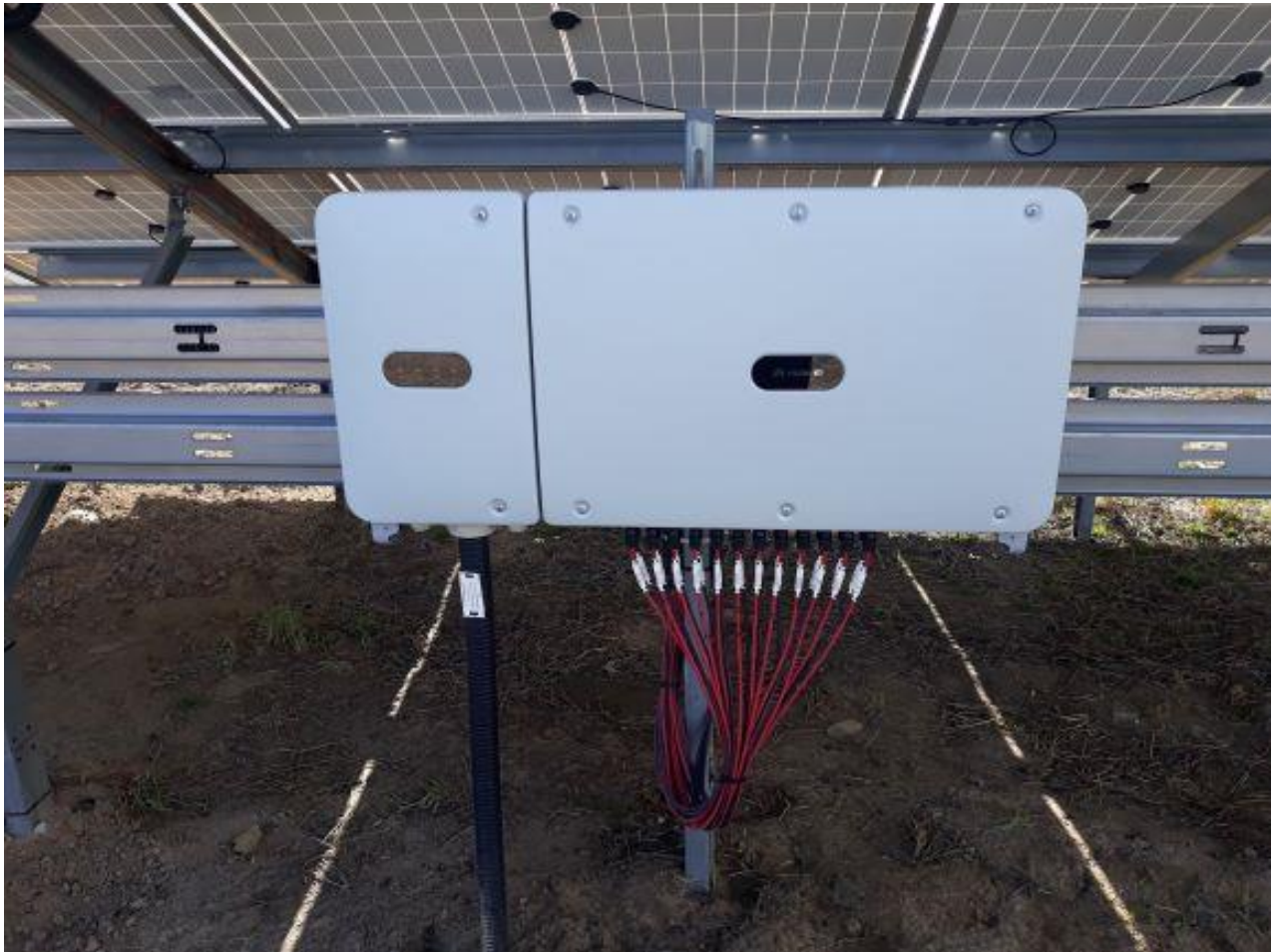
Rycina 9. Przykładowy inwerter farmy fotowoltaicznej.
