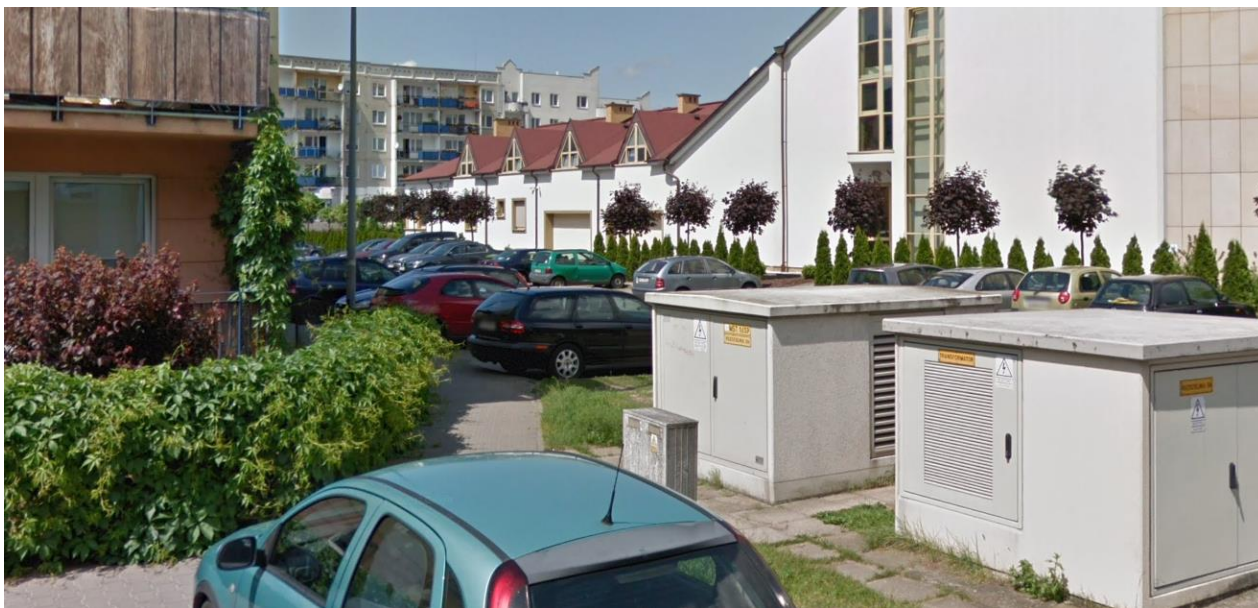
Rycina 11. Standardowa stacja kontenerowa w otoczeniu zabudowy.
