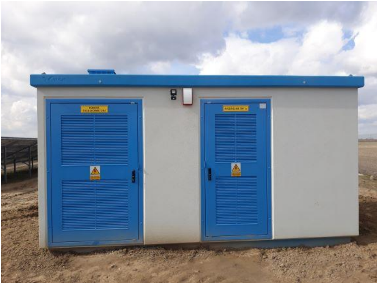
Rycina 10. Przykładowa stacja transformatorowa.
