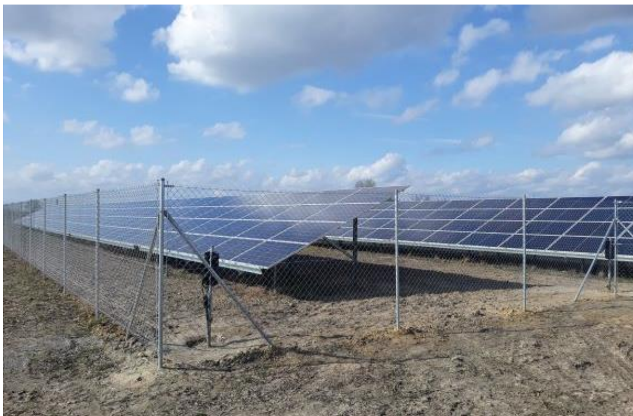
Rycina 13. Przykładowe ogrodzenie farmy fotowoltaicznej.
