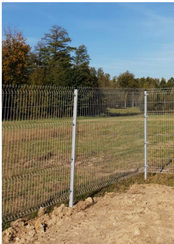
Fot. 5. Ażurowe ogrodzenie farmy fotowoltaicznej z zachowaną przerwą dla migracji małych zwierząt. Źródło: materiały własne firmy ALSEVA INNOWACJE S.A.
