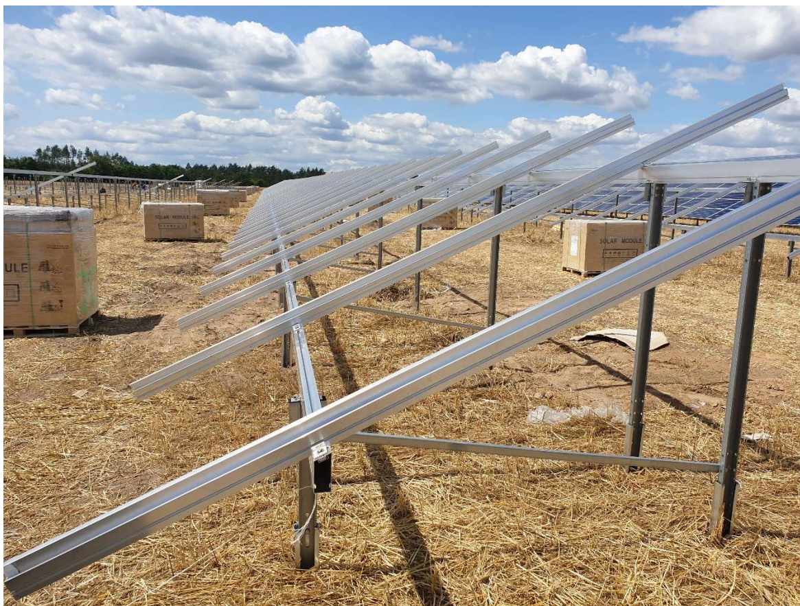
Fot. 4. Konstrukcja przeznaczona do posadowienia paneli fotowoltaicznych.
