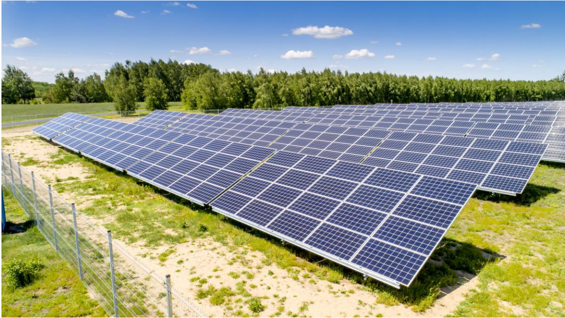
Fot.1. Planowany sposób połączenia paneli fotowoltaicznych [źródło: zasób własny – Farma PV Adamowa Góra]
