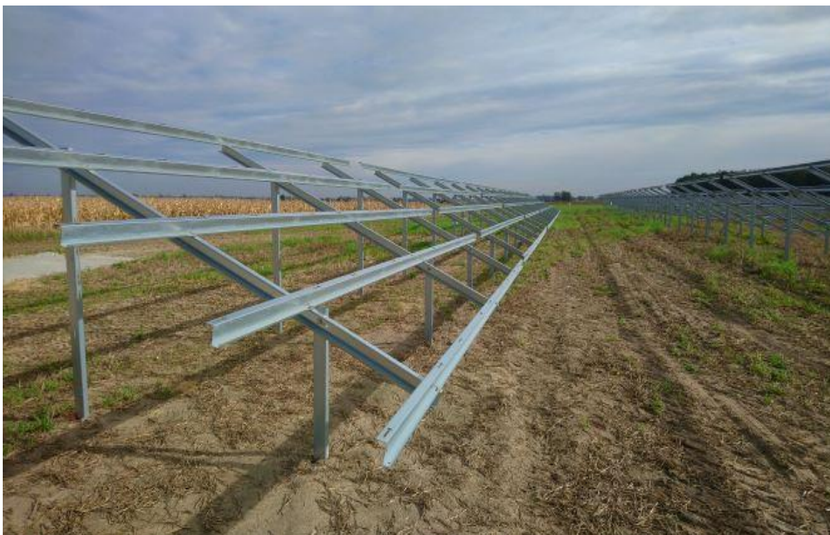
Rycina 5. Konstrukcja stała przeznaczona do posadowienia paneli fotowoltaicznych.
