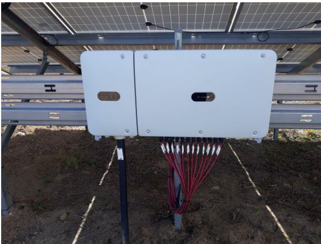
Rycina 7. Przykładowy inwerter farmy fotowoltaicznej.
