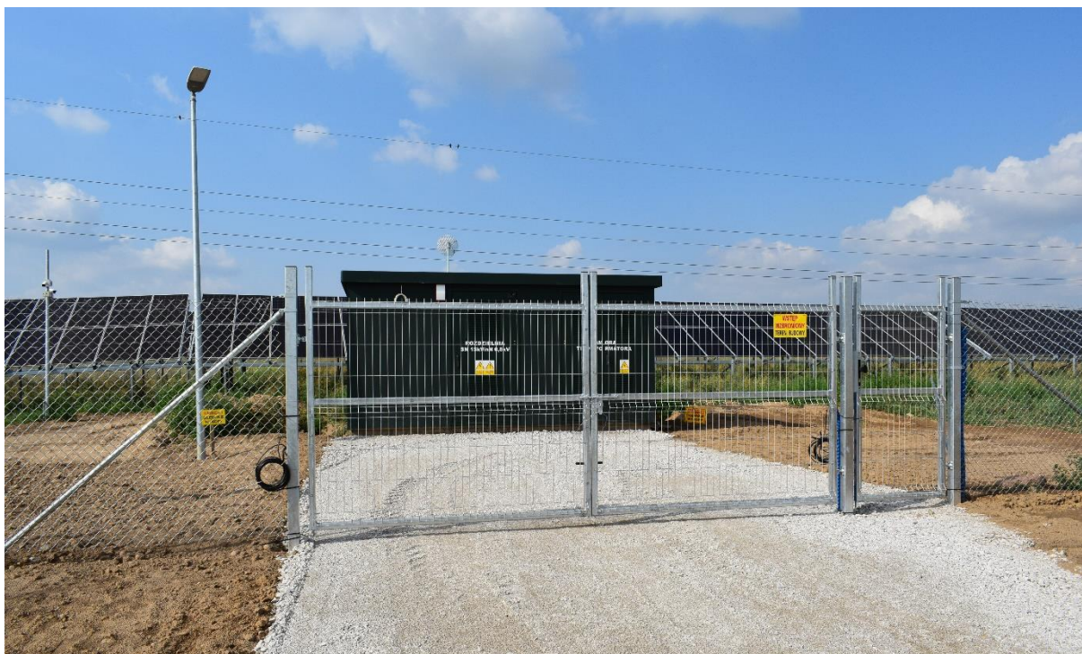
Rycina 8. Przykładowa stacja transformatorowa.
