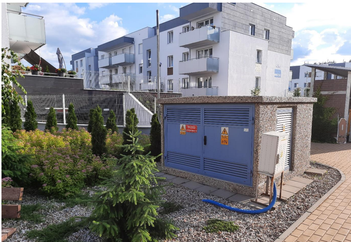
Rycina 11. Stacje transformatorowe w otoczeniu zabudowy mieszkaniowej.
