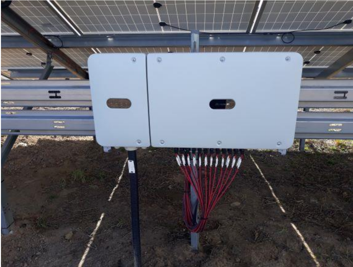
Rycina 7. Przykładowy inwerter farmy fotowoltaicznej.
