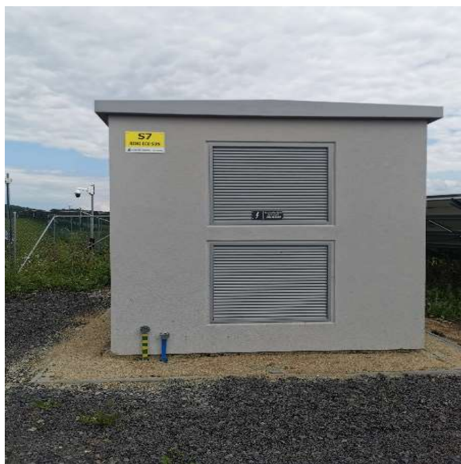
Rysunek 16 Przykładowy budynek stacji transformatorowej.
