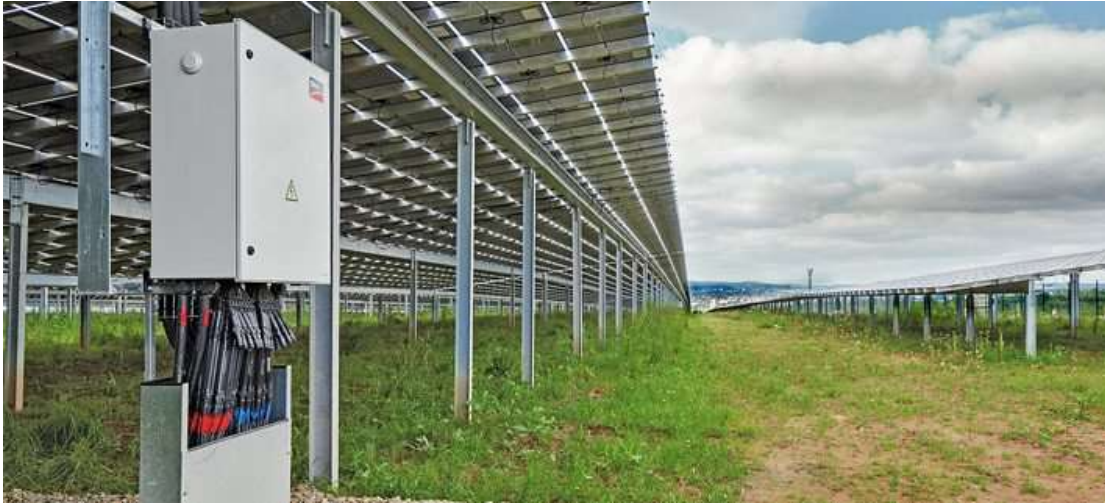
Rysunek 10 Falownik ze string box-em na istniejącej farmie fotowoltaicznej.
