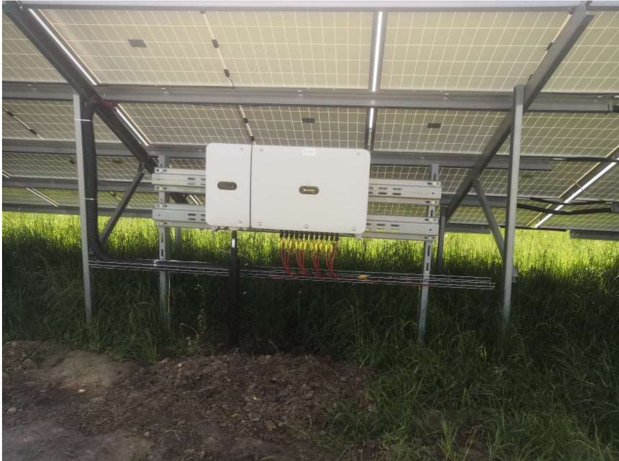
Rysunek 8. Falownik zainstalowane na konstrukcji wsporczej.
