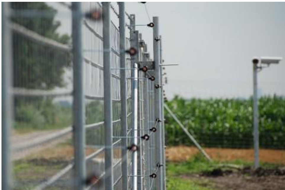
Rysunek 6: Przykładowe ogrodzenie farmy fotowoltaicznej
