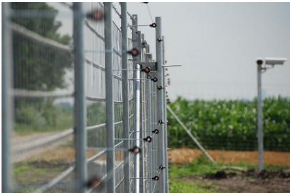
Rysunek 6: Przykładowe ogrodzenie farmy fotowoltaicznej
