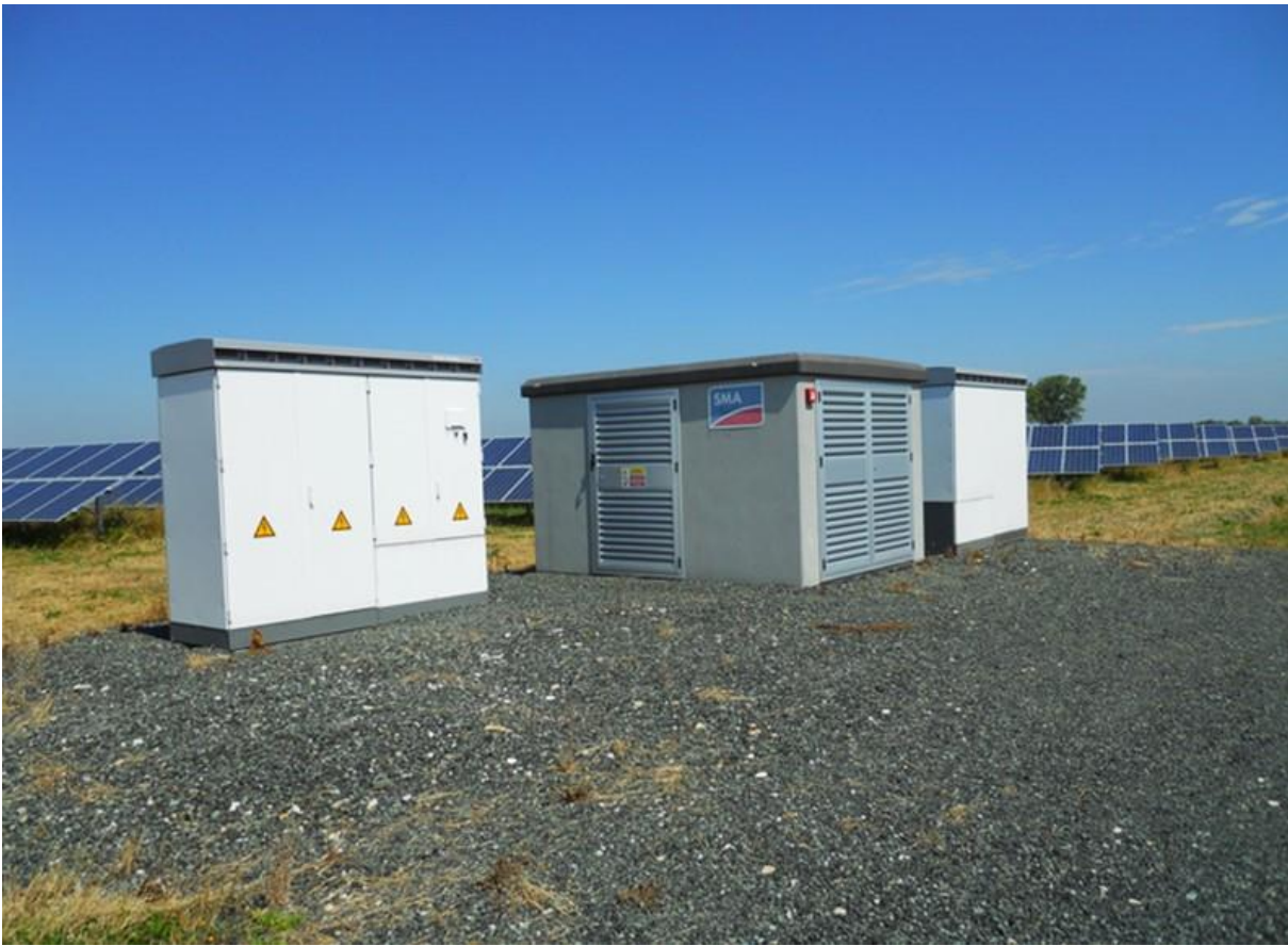
Rysunek 17 Obudowa inwertera w postaci wolnostojącej szafy – obiekt z lewej oraz stacja transformatora – obiekt z prawej
