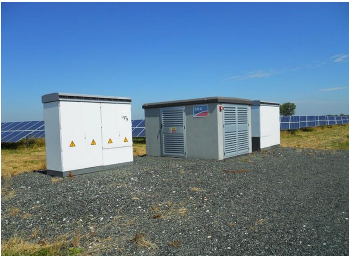
Rysunek 17 Obudowa inwertera w postaci wolnostojącej szafy – obiekt z lewej oraz stacja transformatora – obiekt z prawej
