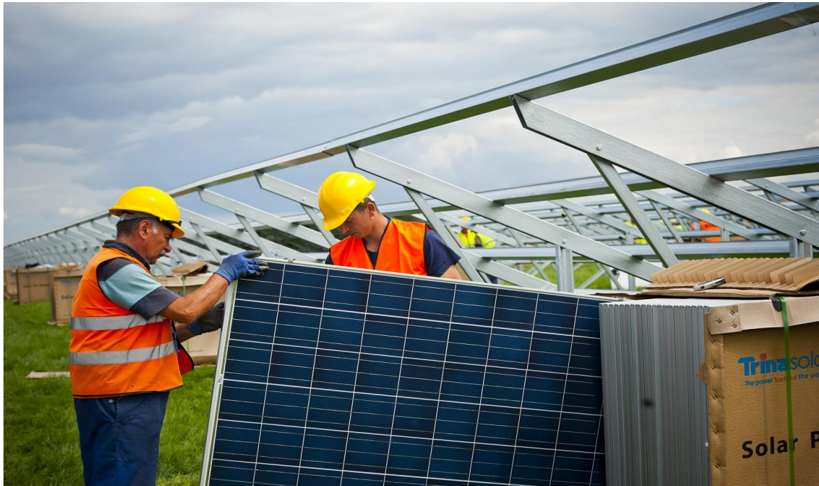
Zdjęcia. Budowa farmy solarnej Bautzen (Niemcy) 38MW na powierzchni ok. 70ha przez polską firmę Remor Solar z Recza (Remor Solar)
