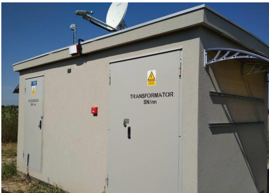
FOTOGRAFIA 6. Przykładowa stacja transformatorowa z urządzeniami sterującymi i monitorującymi, towarzysząca instalacji fotowoltaicznej w miejscowości Olszanka (woj. opolskie) [fot. Paweł Kręciproch]
