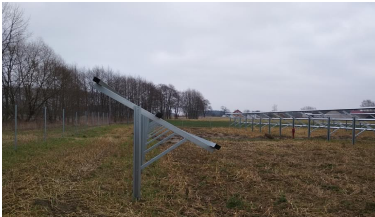
FOTOGRAFIA 4. Przykładowe konstrukcje wsporcze przygotowane do montażu paneli fotowoltaicznych – widoczne kilkunastometrowe odległości między rzędami, [foto: Paweł Kręciproch; instalacja w miejscowości Poddębice]
