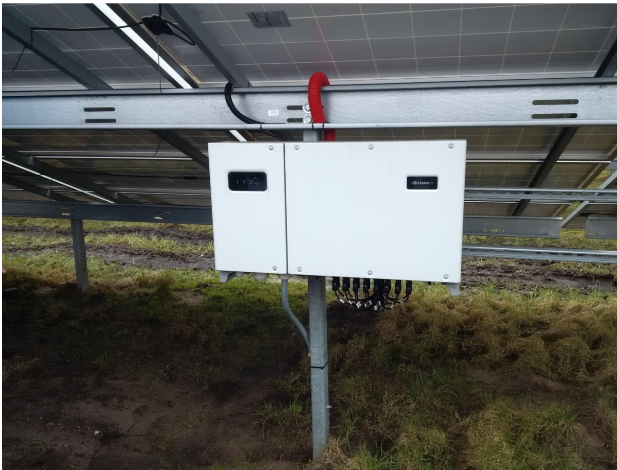
Rysunek 18 Inwerter o mocy 42 kW zamocowany na konstrukcji nośnej paneli fotowoltaicznych
