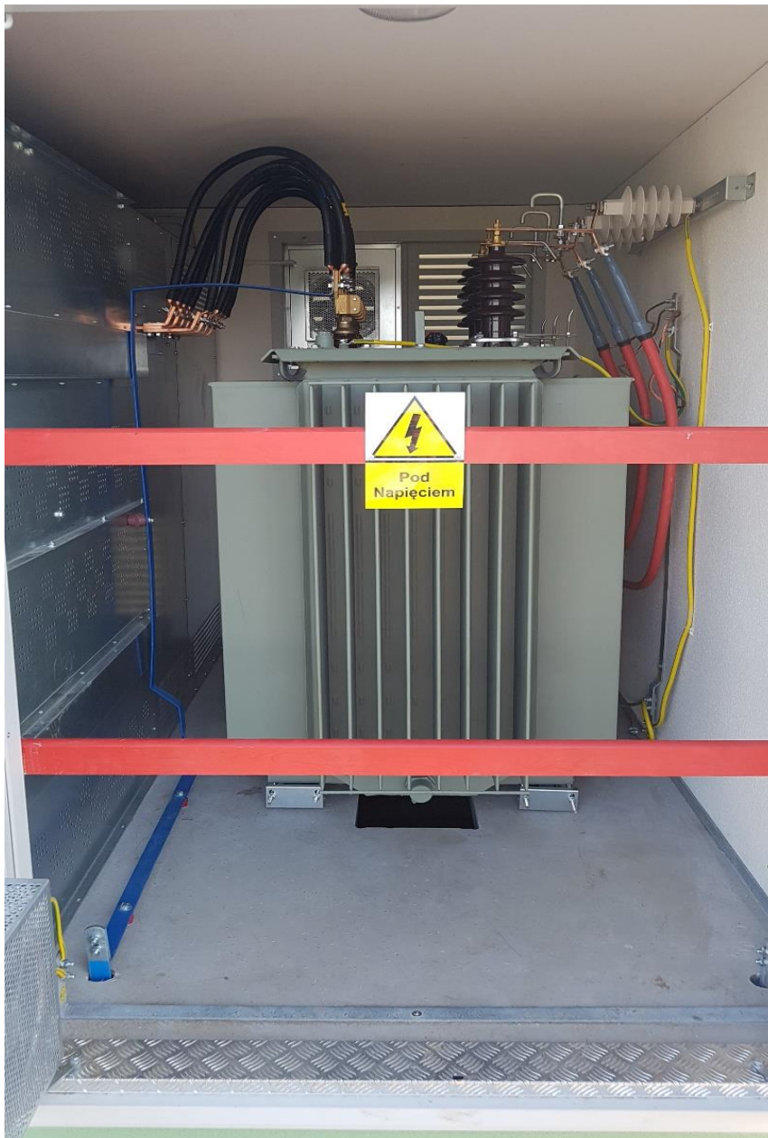
Rysunek 19 Stacja transformatorowa o mocy 0,8 MVA
