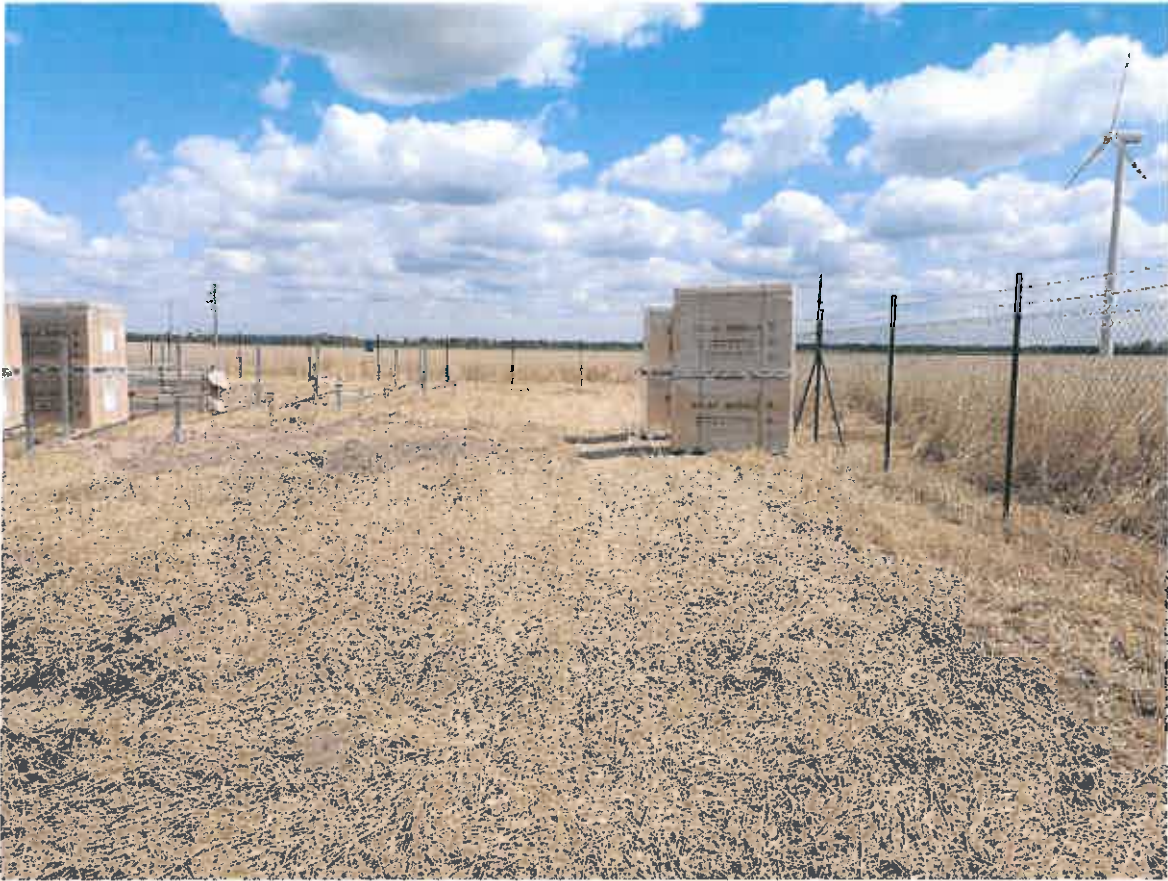
Fot. 2. Przykładowe ogrodzenie farmy fotowoltaicznej.
