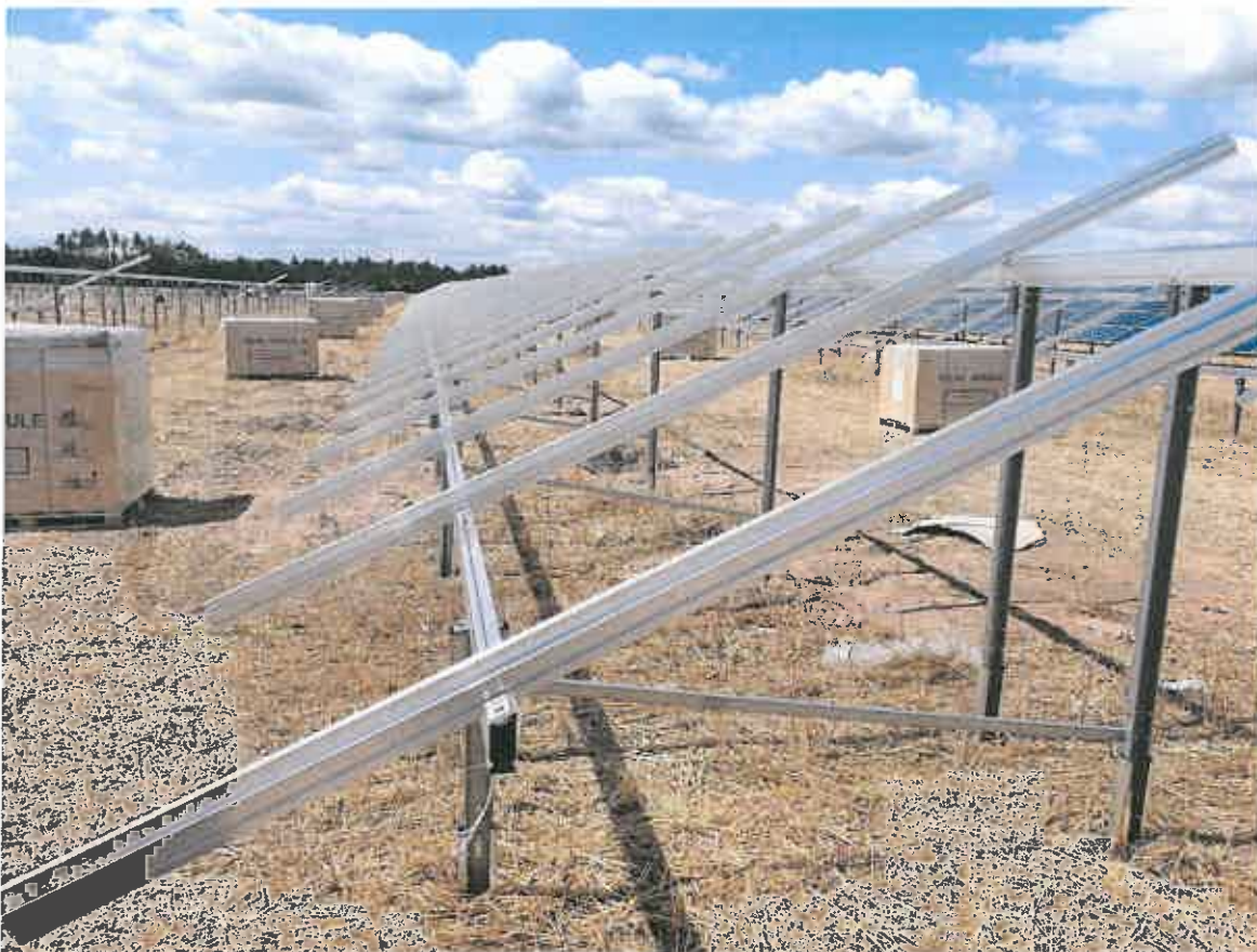
Fot. 4. Konstrukcja przeznaczona do posadowienia paneli fotowoltaicznych.
