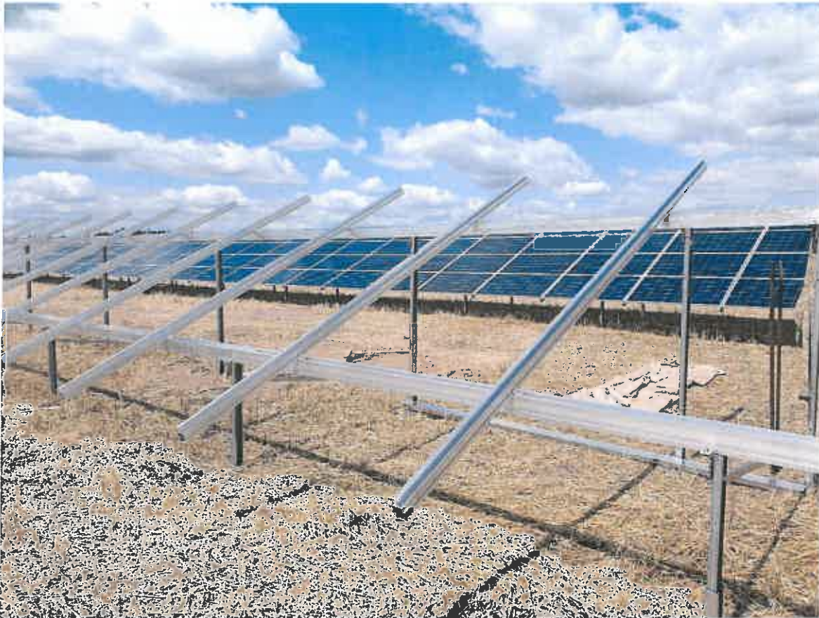
Fot. 1. Konstrukcja stołu z panelami fotowoltaicznymi.
