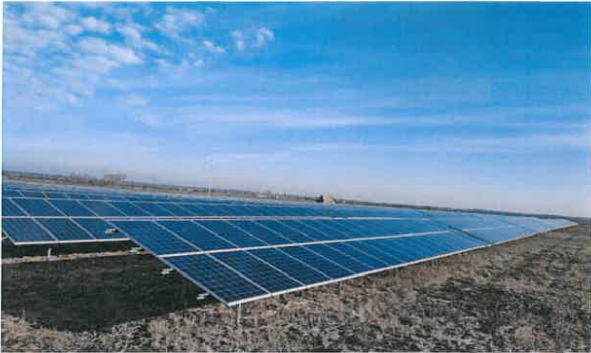
Fot. 8. Widok na instalacje fotowoltaiczną ( https://kk24.pl/pierwsza-w-powiecie-farma-fotowoltaiczna-juz-dziala-jej-energia-pozwala-na-zasilenie-nawet-400-domow/ ).
