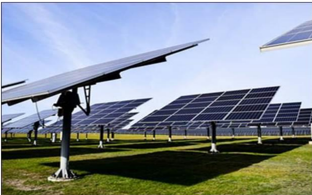
Rycina 6. Konstrukcja śledząca ruch słońca przeznaczona do posadawienia paneli fotowoltaicznych.
