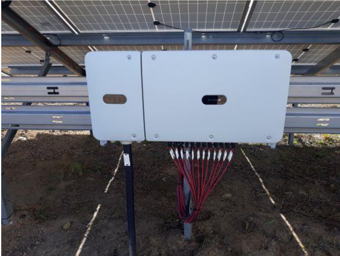
Rycina 7. Przykładowy inwerter farmy fotowoltaicznej.
