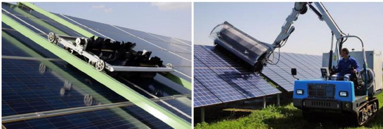
Ryc. 152. Nowoczesne (bezwodne) oraz klasyczne (z użyciem wody) technologie mycia paneli PV. Źródło: instanti.pl
