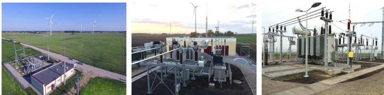
Ryc. 19. Przykładowa abonencka stacja elektroenergetyczna przy farmie wiatrowej Parsówek 26 MW. Źródło: Elmont Grupa.
