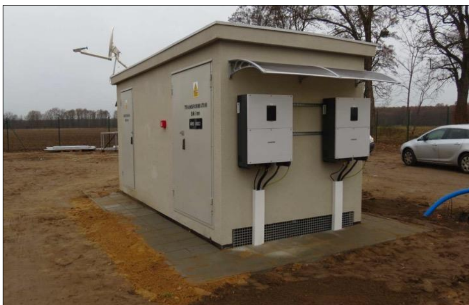
Ryc. 136. Falowniki zainstalowane na stacji transformatorowej SN. Źródło: Materiały własne
