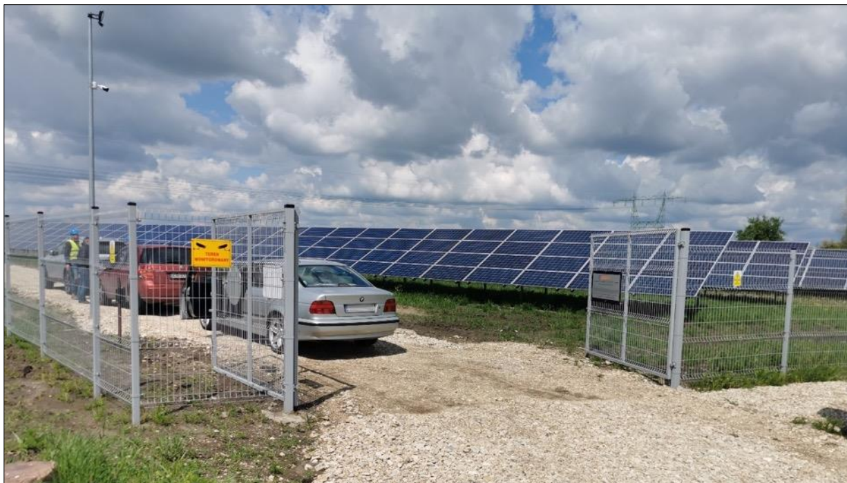
Ryc. 141. Przykładowe ogrodzenie, brama wjazdowa, kamera monitoringu, oświetlenie, droga dojazdowa. Źródło: materiały własne.
