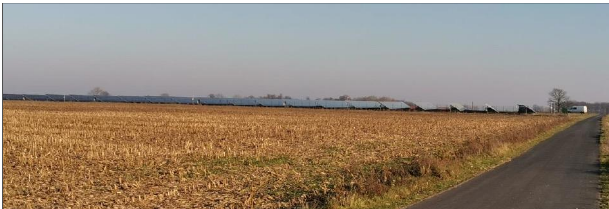
Ryc. 196. Zdjęcie elektrowni fotowoltaicznej z odległości ok. 200 metrów. Źródło: Materiały własne.
