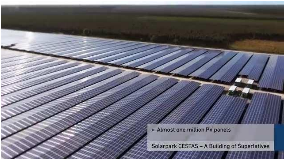
Rys. 13: Przykładowe ułożenie wschód - zachód paneli fotowoltaicznych na farmie Cestas we Francji.
