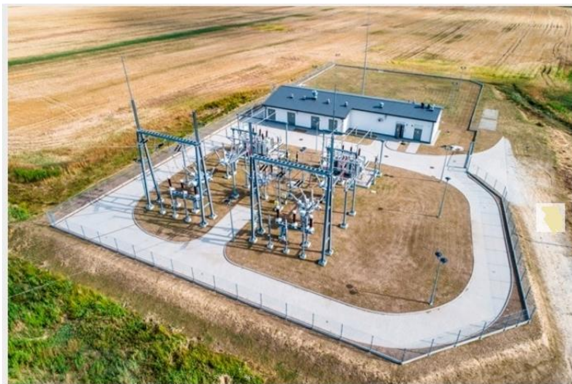
Rys. 15: Przykładowa stacja trafo WN/SN o mocy 2 x 25 MVA Korczowa (budynek i urządzenia)
