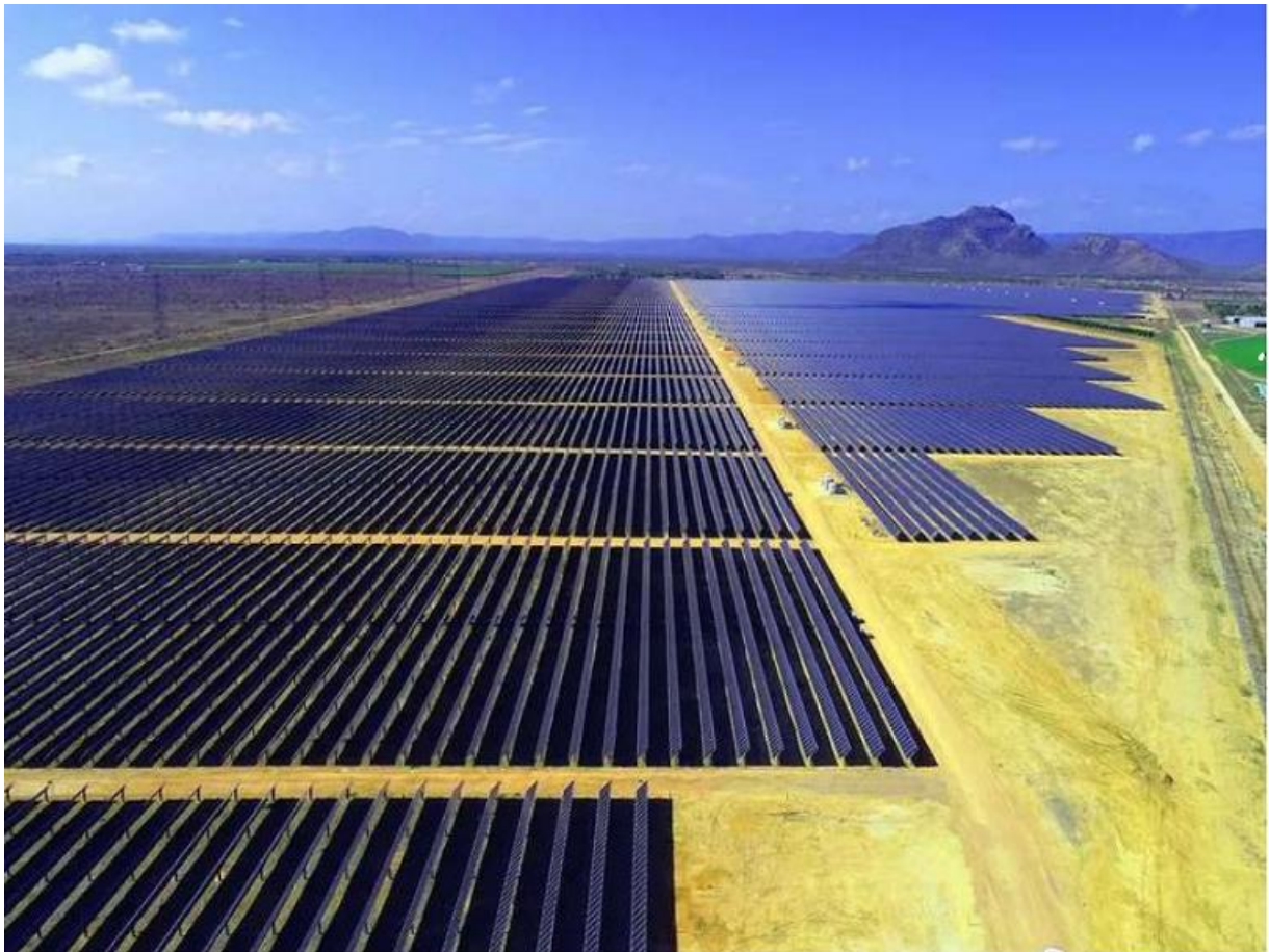
Rys. 12: Przykładowe ułożenie na południe paneli fotowoltaicznych na farmie Australia – Asia
