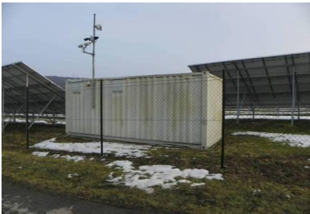
FOTOGRAFIA 6. Przykładowa kontenerowa stacja transformatorowa z urządzeniami sterującymi i monitorującymi, towarzysząca instalacji fotowoltaicznej - rejon miejscowości Tremesna, Republika Czeska [fot. Krzysztof Kręciproch]
