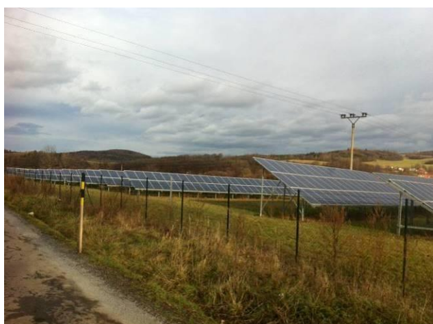
FOTOGRAFIA 4. Przykładowa naziemna instalacja fotowoltaiczna - rejon miejscowości Tremesna, Republika Czeska [fot. Krzysztof Kręciproch]
